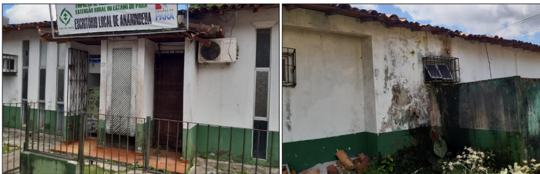
FOTO 01e 02 : ESTADO DE CONSERVAÇÃO EXTERNA DO IMÓVEL (FRENTE)
