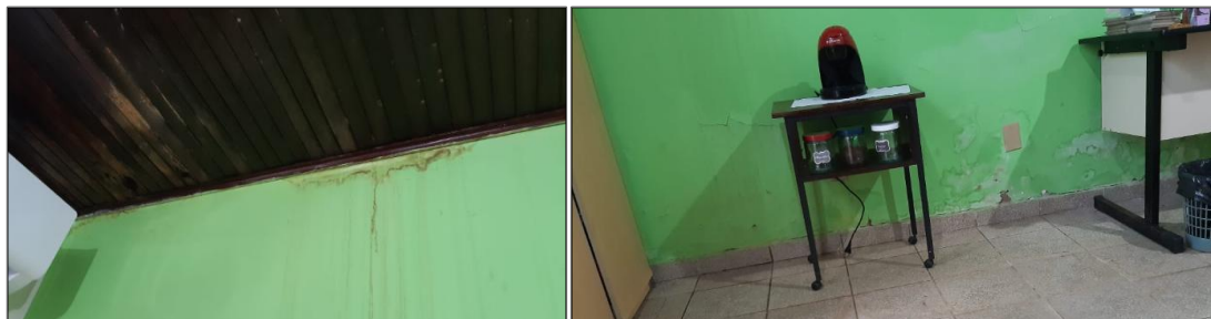
FOTO 03 e 04 : ESTADO DO FOORO DE MADEIRA E UMIDADE NAS PAREDES INTERNAS
