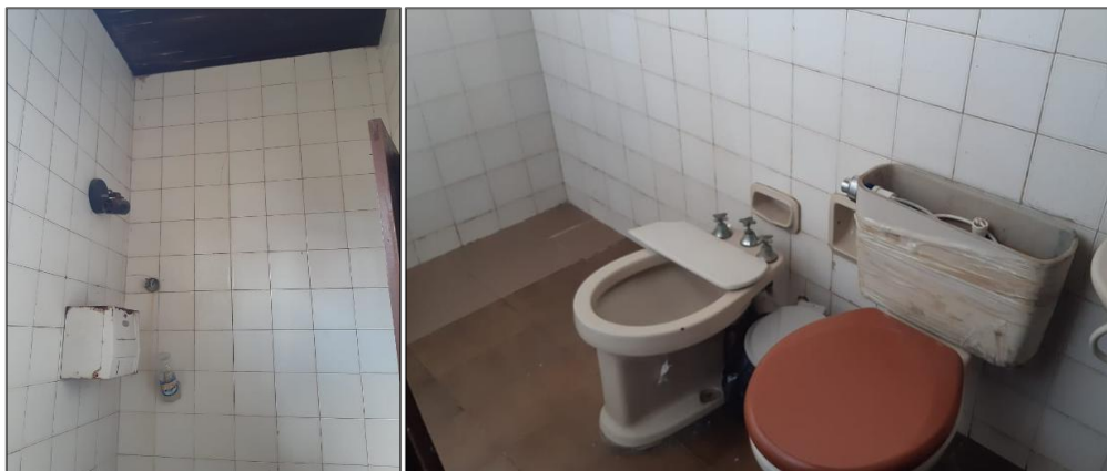
FOTO 05 e 06: CONDIÇÕES ATUAIS DAS INSTALAÇÕES HIDRO SANITÁRIAS
