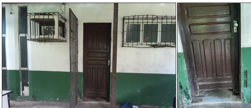
FOTO 07 E 08 : ESTADO DE CONSERVAÇÃO EXTERNA DO IMÓVEL (FUNDOS)
