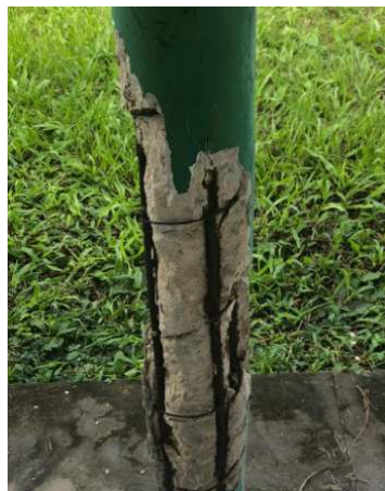
FOTO 03: SETOR DE FRUTAS - PILARES DE SUSTENTAÇÃO EM COROSSÃO AVANÇADA
