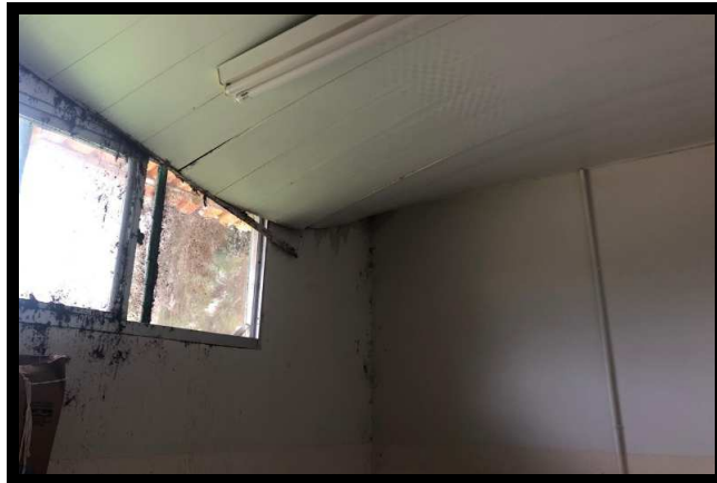
FOTO 02: LATICÍNIOS – FORRO PVC EM DESABAMENTO
