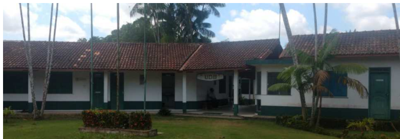
FOTO 09: PRÉDIO PRINCIPAL (UDB) – INFILTRAÇÕES E PINTURA EXTERNA
