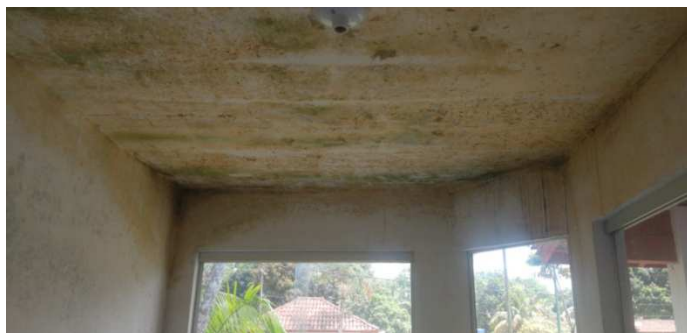
FOTO 10: PRÉDIO PRINCIPAL (UDB) - UMIDADES INTERNA E INFILTRAÇÕES
