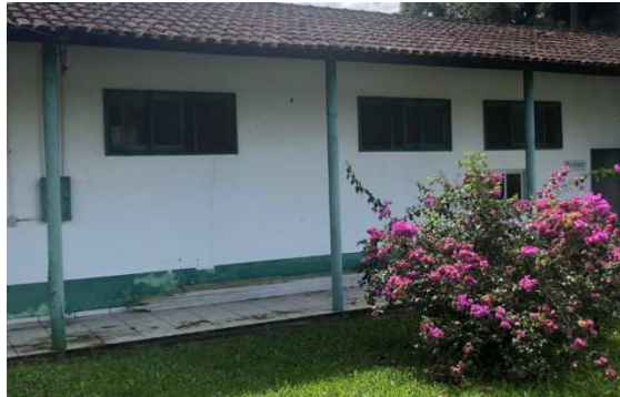
FOTO 04: SETOR DE FRUTAS – ESTADO DE CONSERVAÇÃO DA PINTURA EXTERNA
